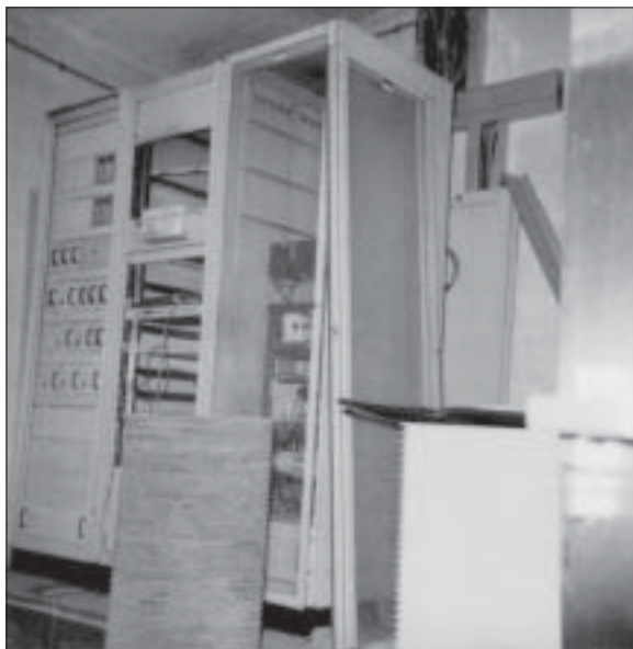
Cuarto de equipos del PCL de Plaza de España.
