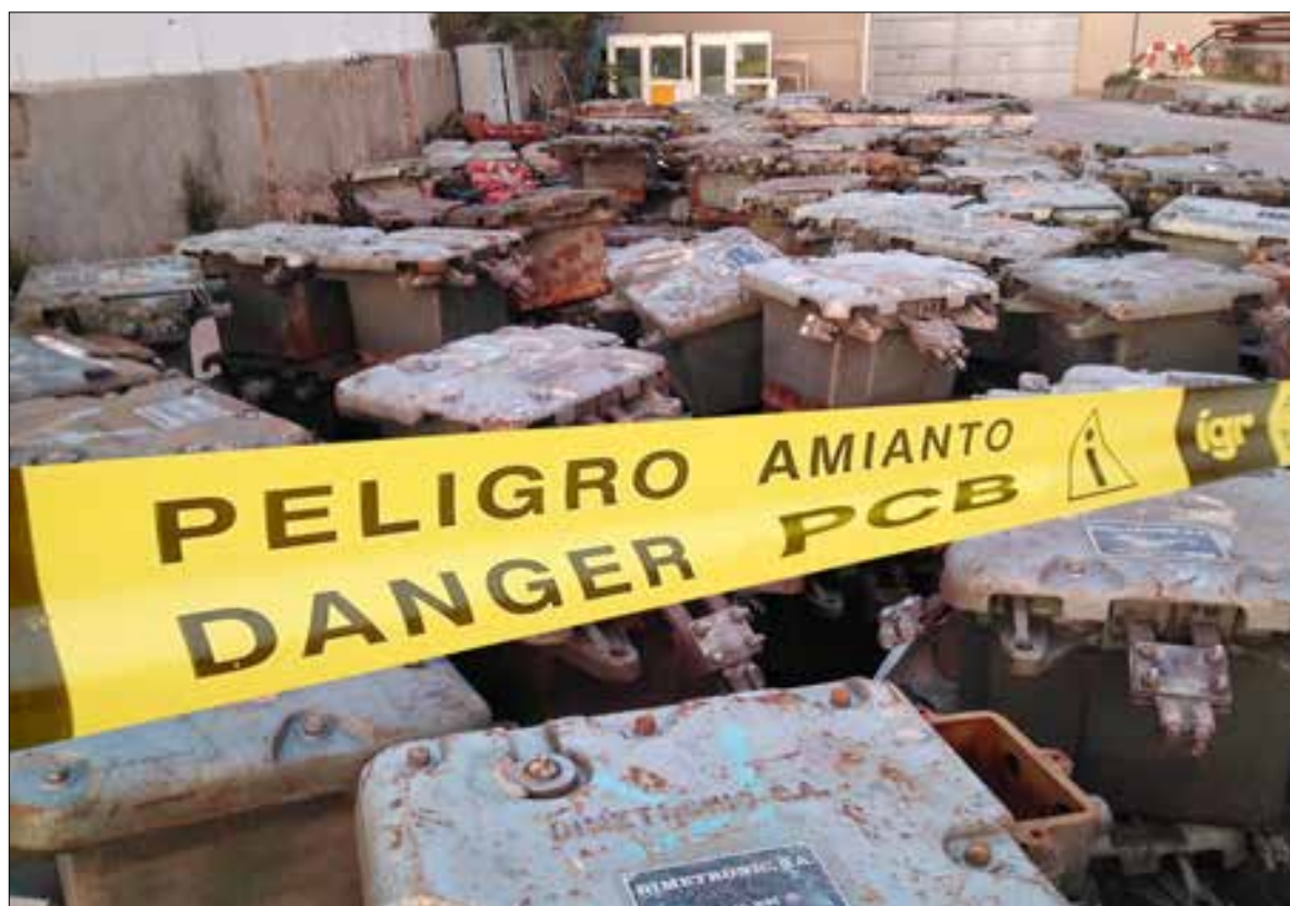
Galápagos: Juntas Inductivas con Amianto y PCBs en C. Caminos
